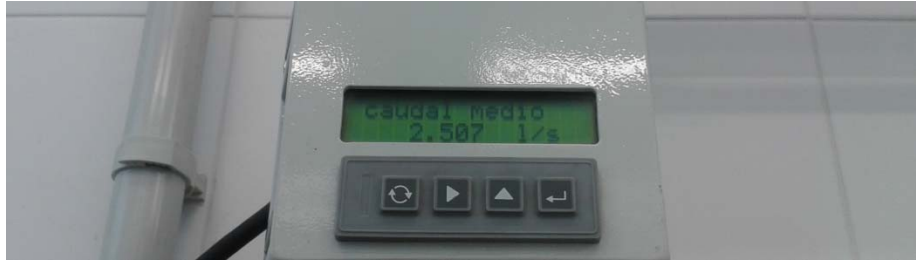
Figura 6. Medida de caudal con caudalímetro electromagnético.
