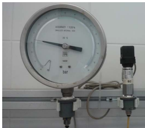
Figura 12. Manómetro junto a transductor para el control de la presión en la instalación.
