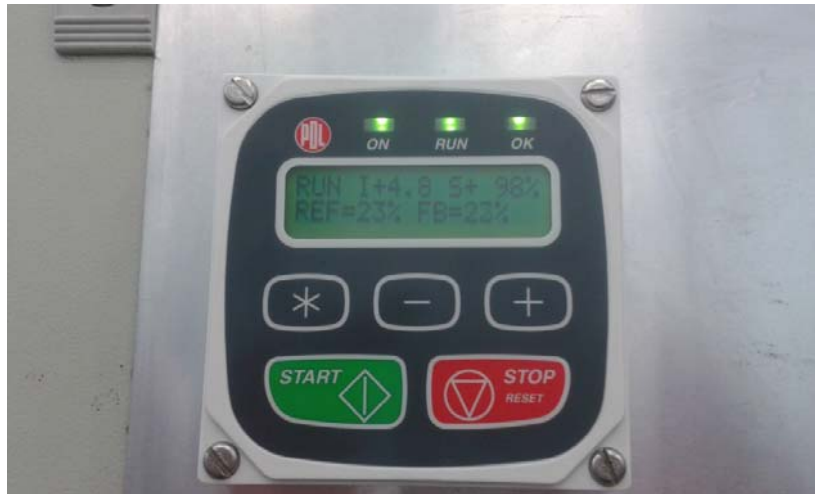
Figura 13. Indicador del variador de frecuencia que controla el grupo de bombeo.
