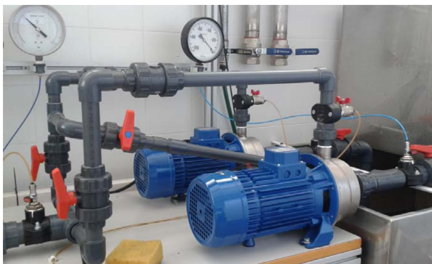
Figura 5. Banco de ensayo de asociación de bombas (Lab. Ingeniería Hidráulica).
