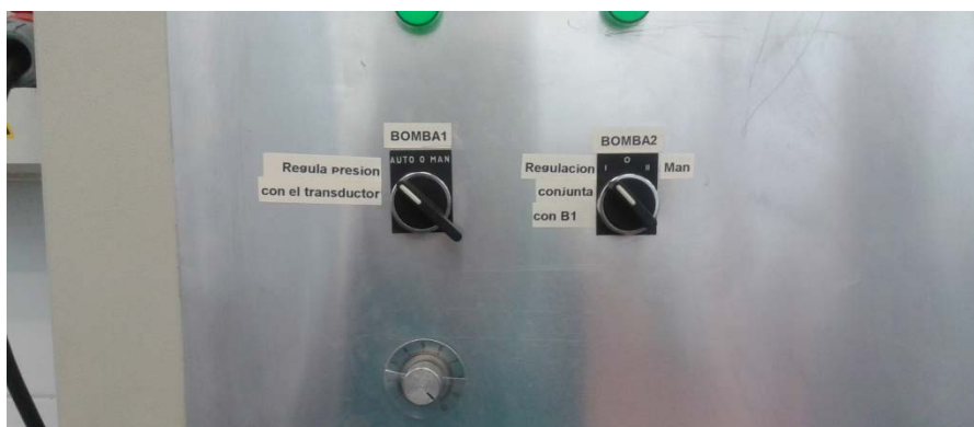
Figura 8. Cuadro de mando que activa el modo de funcionamiento.
